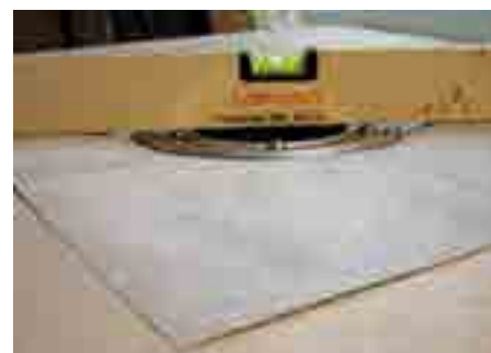
6. Verificarea căderii șapei pentru scurgere bună
